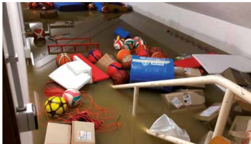
■ Stanze allagate con materiale danneggiato durante le alluvioni dello scorso maggio e giugno a Castelfranco Veneto
